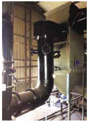
空污防制設備
