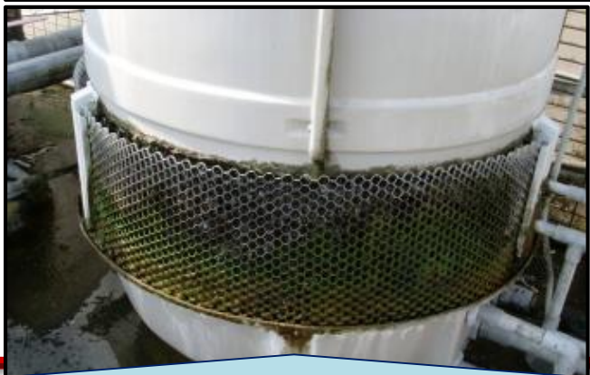
冷卻水塔老舊散熱效率不佳
