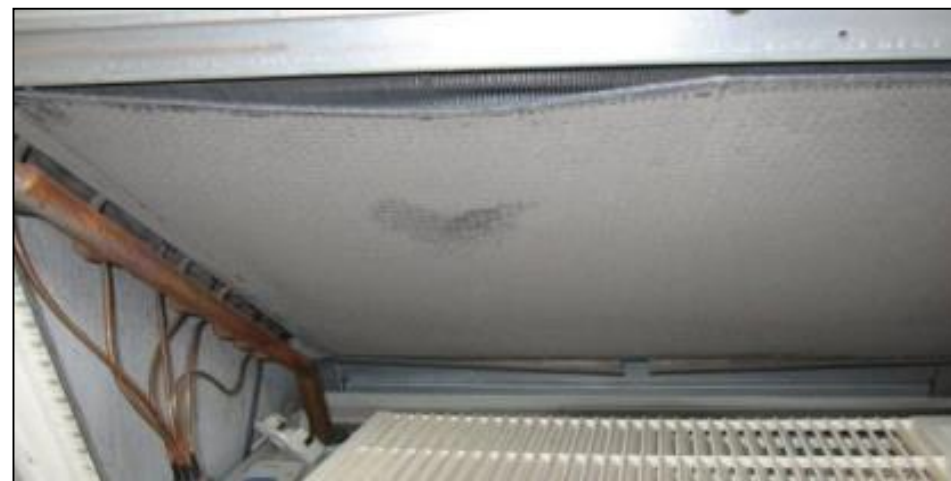
空調箱濾網髒污未清洗2
